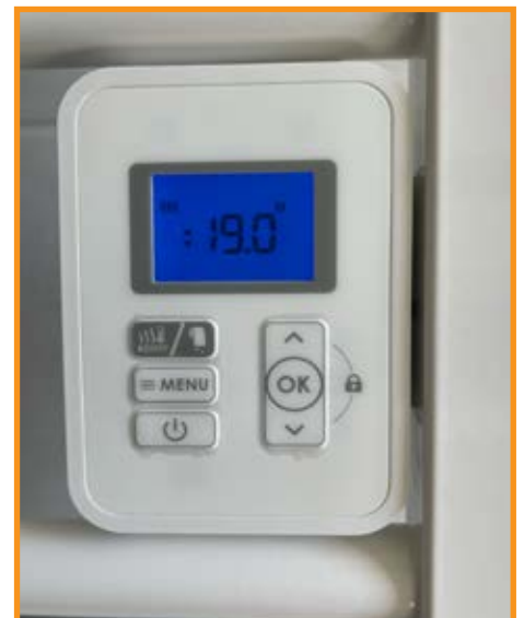
Convecteurs salle de bains
